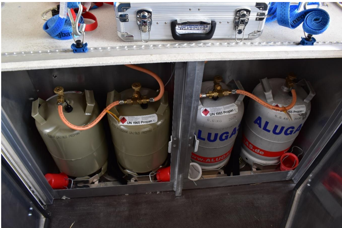
Abbildung 52: Freistehendes Monitoringsystem unabhängige Energieversorgung Gasvorrat Quelle: Eigene Darstellung
