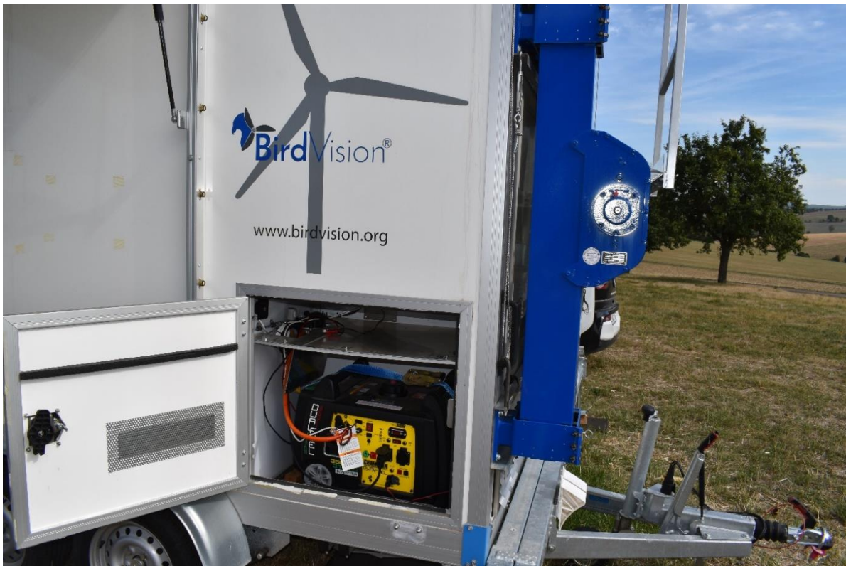
Abbildung 51: Freistehendes Monitoringsystem unabhängige Energieversorgung mit Generator Quelle: Eigene Darstellung
