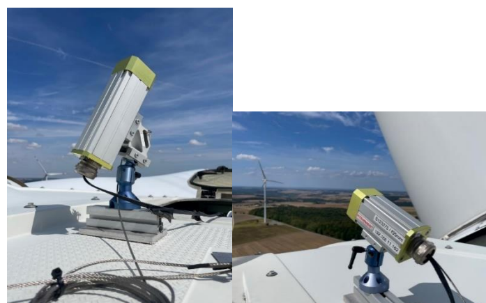
Abbildung 65: Installierte Kameras auf der Gondel der Windenergieanlage Quelle: Eigene Darstellung
